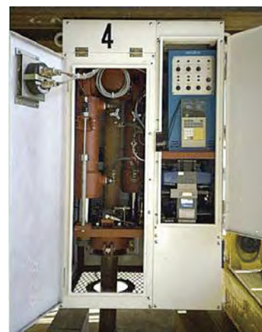
ジャッキ制御室
