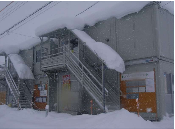
建物屋根の雪庇
